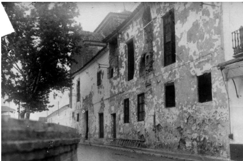
Aspecto ruinoso de la fachada del Hospital de San Juan de Dios antes de las reformas de la segunda mitad del siglo XX.
